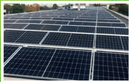
PV-Anlage auf Industriedach
